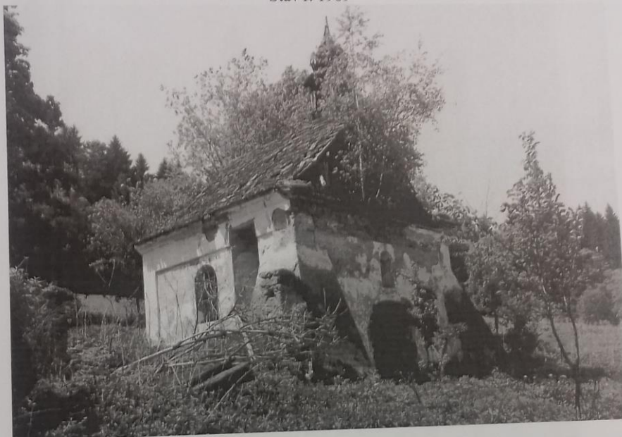
Obr. 13: Kaple sv. Barbory v Podlesí Stav r. 1989
